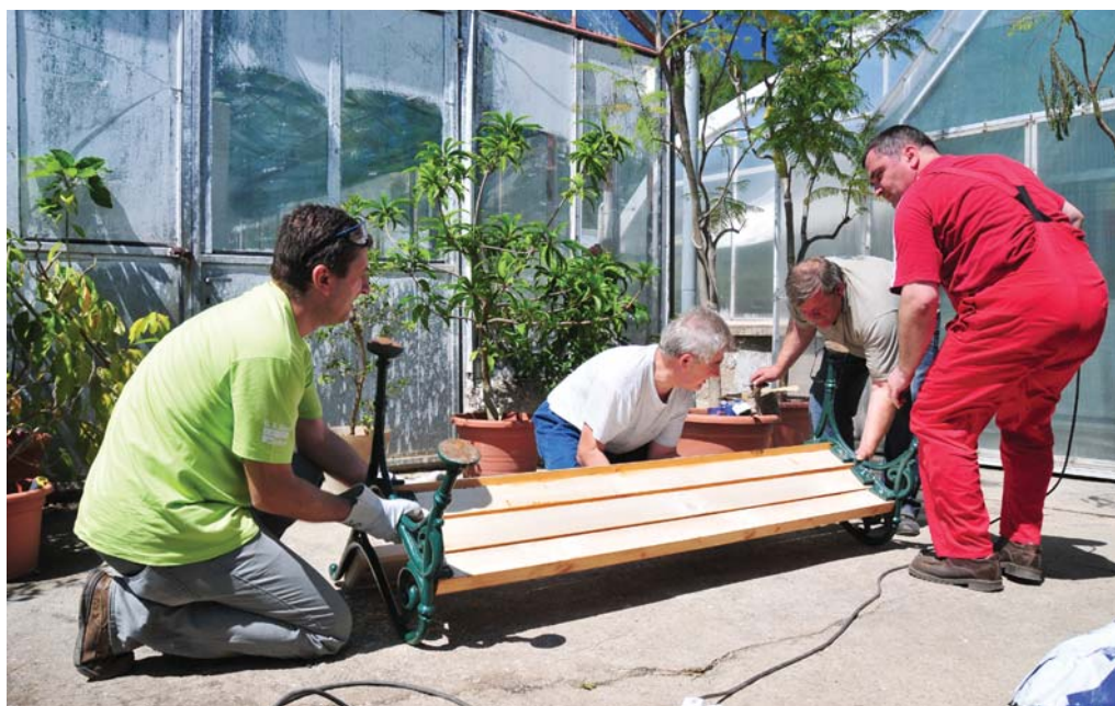
Pri výmene sedadiel a operadiel exteriérových lavičiek sa činil aj riaditeľ pre environment prvovýroby a podpory výroby Miloš Fodor (vľavo).
