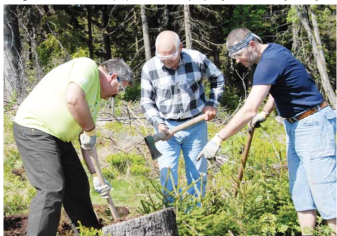
V plnom nasadení pri úprave terénu (zľava doprava): Jaroslav Takáč, Peter Horňák a Róbert Gonda.
