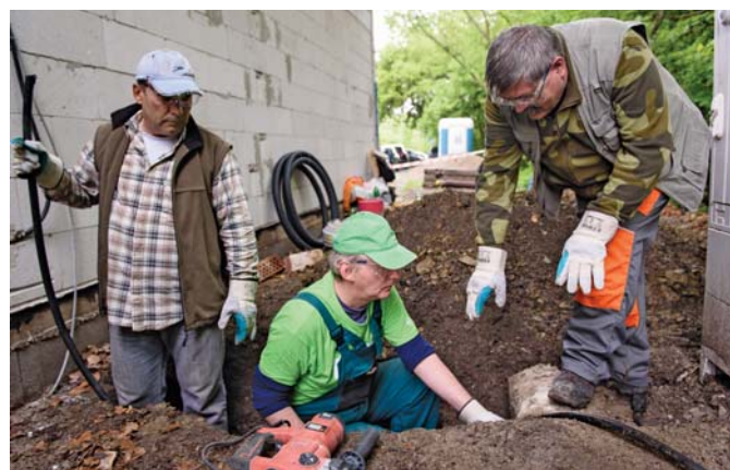
Michal Tančák, Pavol Petrás a Jaroslav Takáč (zľava doprava) pri výkope jamy pre prívodný elektrický kábel pre novú stanicu.
